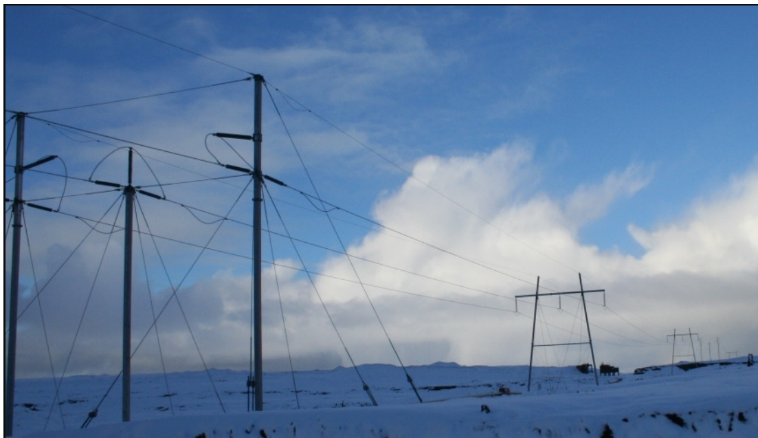
Mynd 4.4 Upphaf Rauðamelslínu 1 frá Reykjanesvirkjun.
